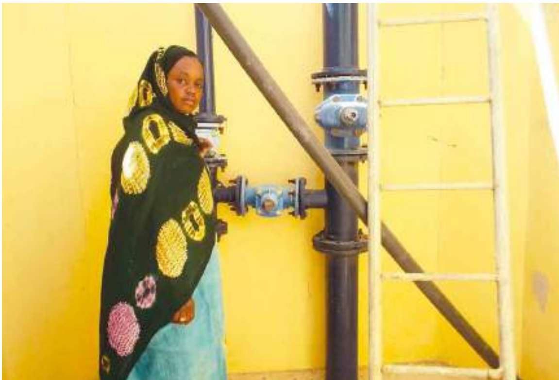
Distribution d'eau à Mboubène
